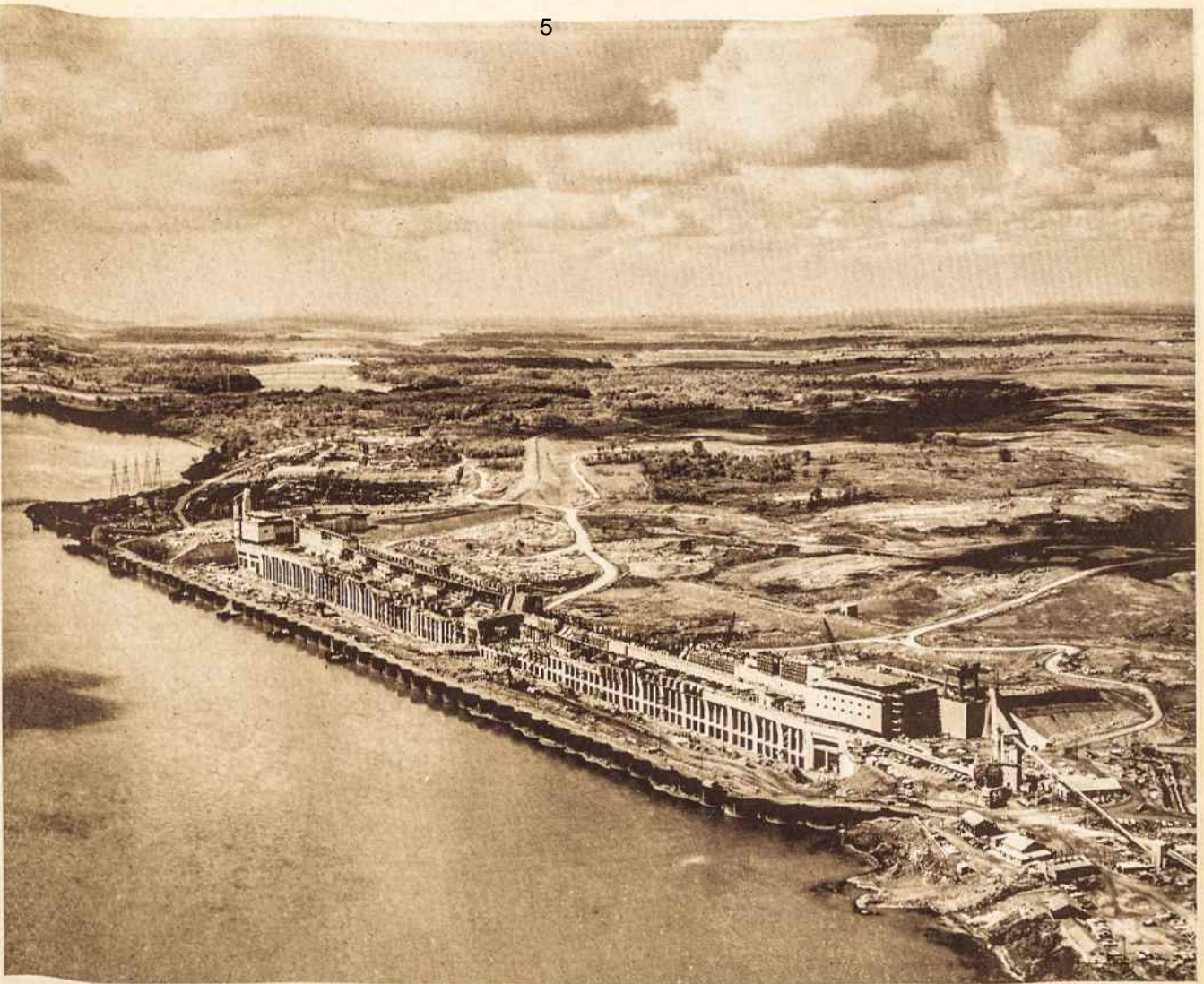
Pav. 1. Barnhart Salos vandens jėginės statybos vaizdas 1957 m. spalio mėnesį. Abiejuose galuose matomi mašinų įrengimo bei remonto pastatai. Masyvinis blokas jėginės viduryje atitinka J.A.V. ir Kanados sieną. Kairėje tolimoje matyti Long Sault užtvankos statyba. (Fotc HEPCO).
