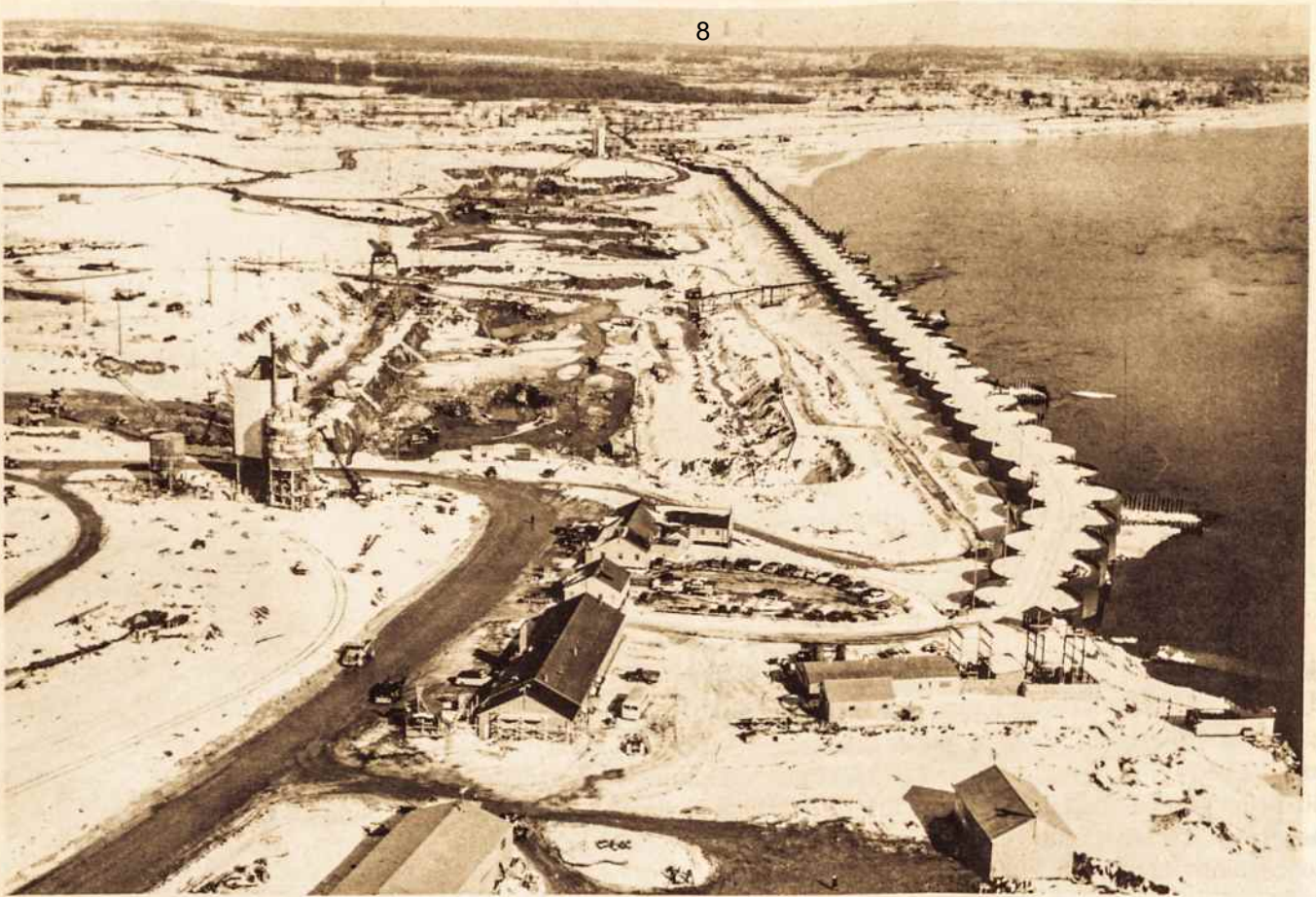
Pav. 6. Štatybos vietos vaizdas 1956 m. sausio mėnesį. Žemė baigiama iškasti iki uolos. Tolimame gale pamatai ruošiami atraminėms sienoms. Dešinėje matyti 3,500 pėdų ilgio viena iš laikinųjų užtvaryų statybos vietos nusausinimui. (Foto HEPCO).
